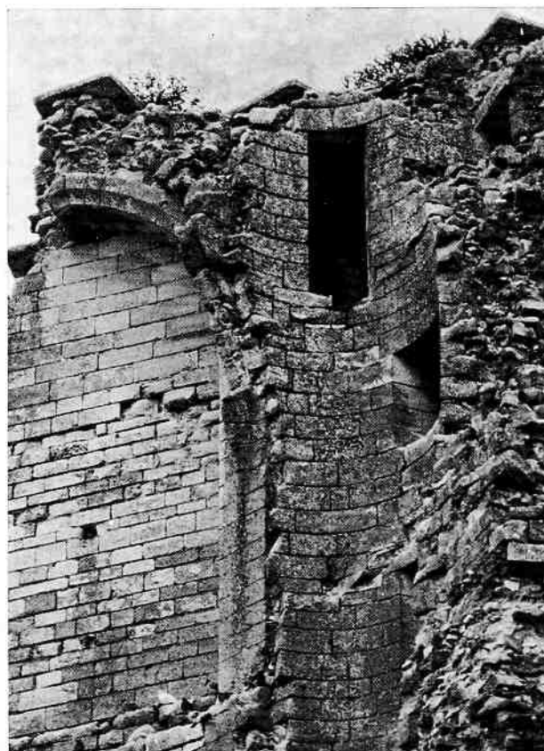
FIG. 2. — LA CAGE DE L'ESCALIER EN VIS Remarquer la parfaite coïncidence des assises avec celles du pilastre; noter également les traces des anciennes marches arrachées. En haut, le débouché de l'escalier rampant; sa position haute par rapport à la coupe de la figure précédente confirme l'existence de cet escalier rampant.
