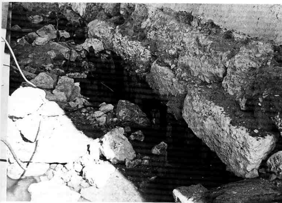
Vides sous la base d'un appui
